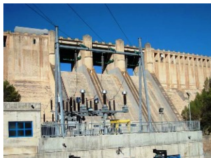
Central Hidroeléctrica Alcántara – Cáceres
