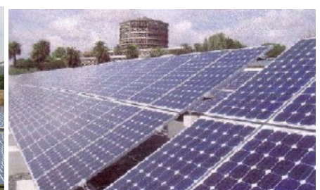
Planta de energía solar fotovoltaica de 500 kw en Córdoba
