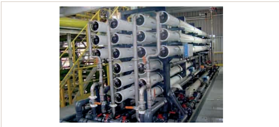
Figura 12.3.4. Instalación de ósmosis inversa
