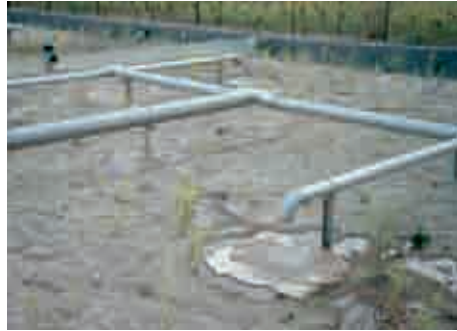
Vista del sistema de distribución del agua residual en un humedal de flujo subsuperficial vertical al inicio de funcionamiento (sin vegetación desarrollada) (Francia). Fotografía: Pascal Molle.
