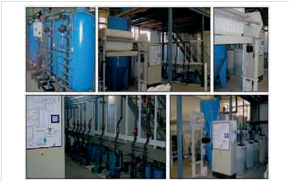
Figura 12.4.3. Instalación de intercambio iónico
