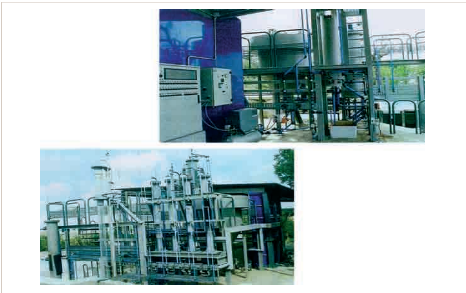
Figura 12.4.2. Instalación de tratamiento con carbón activo
